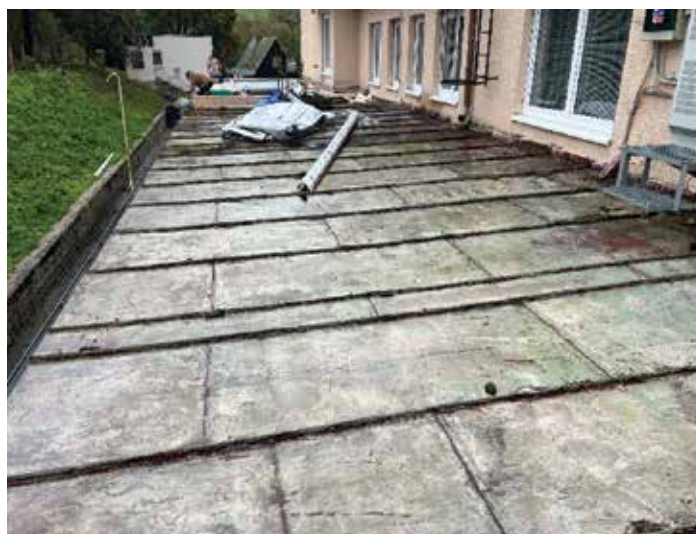
Stará střecha na části objektu RS KORD
