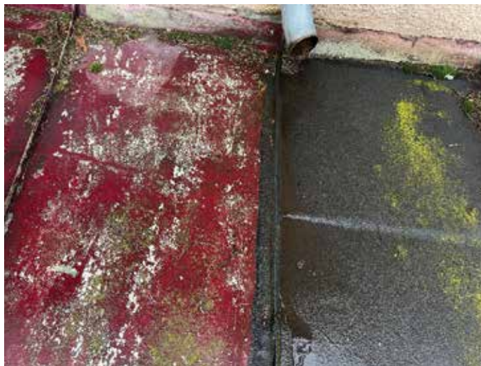
Stará střecha na části objektu RS KORD
